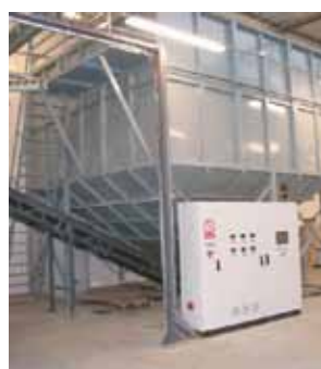
Silos materiałowy i szafa sterująca
